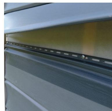
Неправильно смонтирована мембрана. Должна быть установлена до обрешетки. Нет зазора между мембраной и фасадным материалом.
