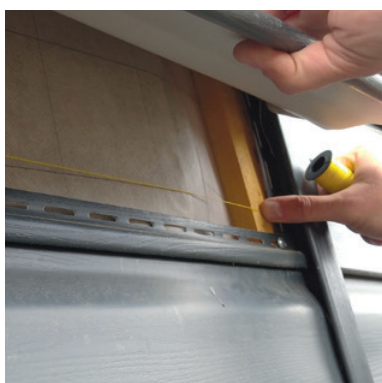
Утеплитель выпирает наружу. Перекрывает вентканал, выталкивает сайдинг.
