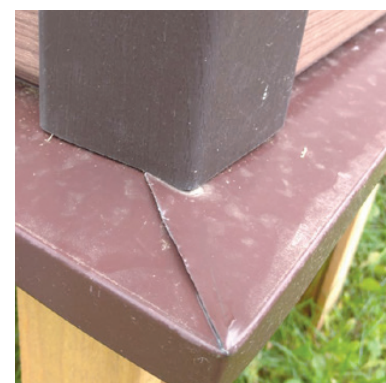
Нет зазора между доборным элементом и отливом.
