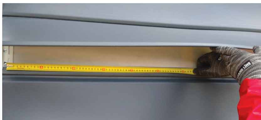
Мембрана неверно смонтирована. Должна быть смонтирована под обрешеткой. Саморезы в тело доборного элемента. Неверный шаг обрешетки.
