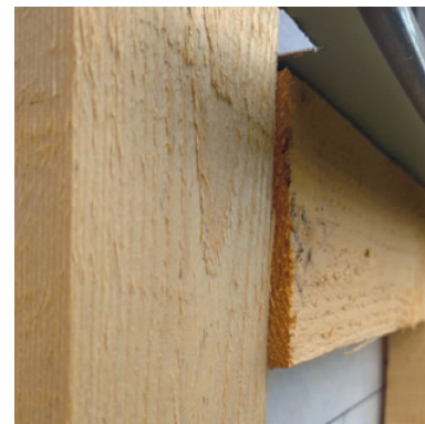
Обрешетка не в плоскости. Перекрыт вентиляционный канал.
